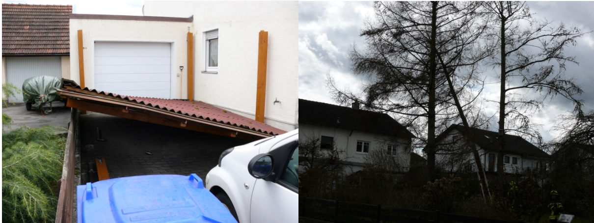
Das Dach des Carports wurde aus der Verankerung gerissen; Bäume drohen zu stürzen
